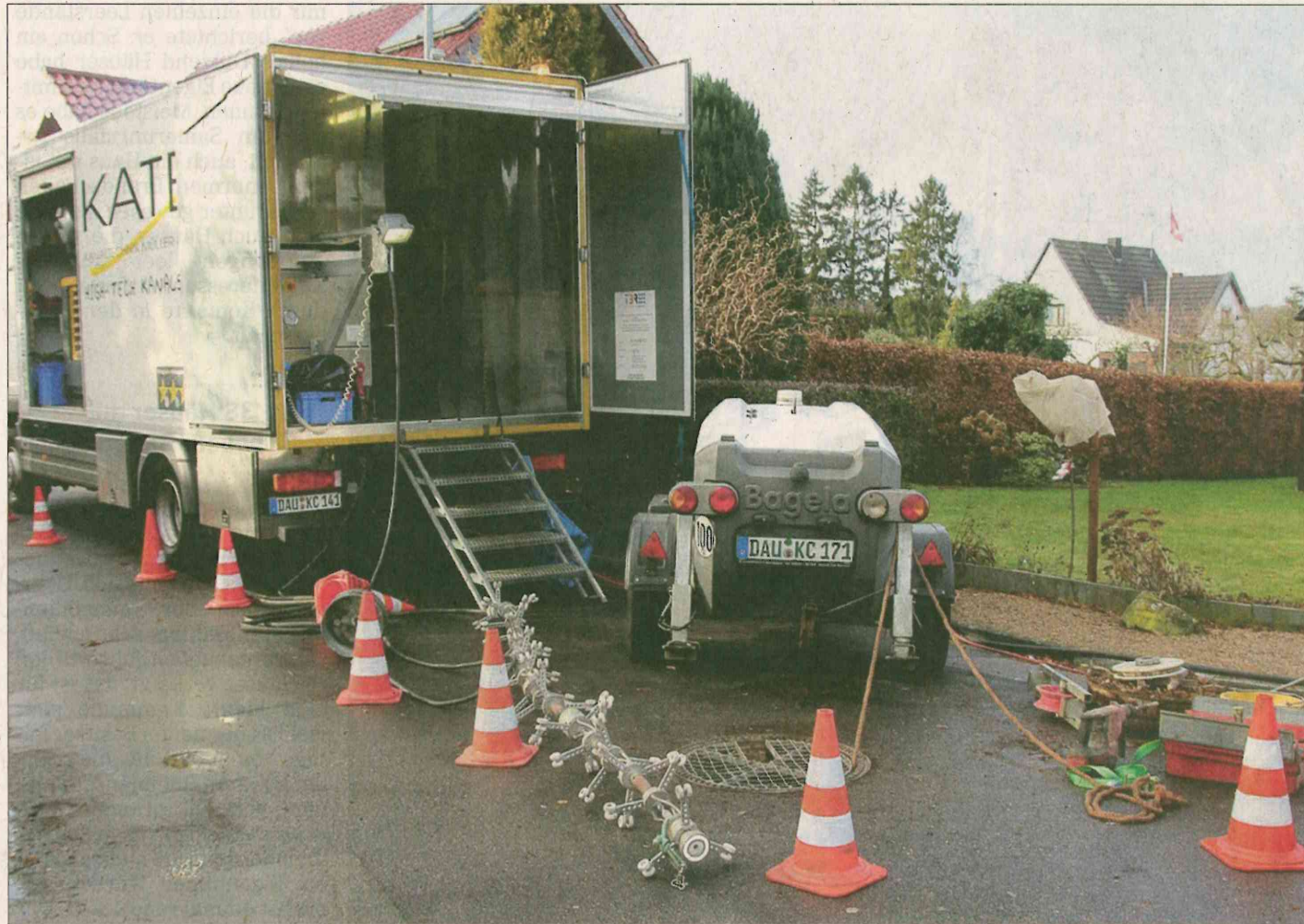
Mit dieser UV-Lichterkette härtet die Firma Katec Harz aus, das auf beschädigte Stellen im Kanal aufgetragen wurde. (Foto: Profipress)
