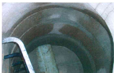
Vor der Beschichtung des Schachtes wurden weitere Vorarbeiten durchgeführt, wie das Abdichten undichter Fugen und das Reprofilieren der Gerinne sowie partielle Vorbeschichtungen an ausgebrochenen Teilen und Fehlstellen.
